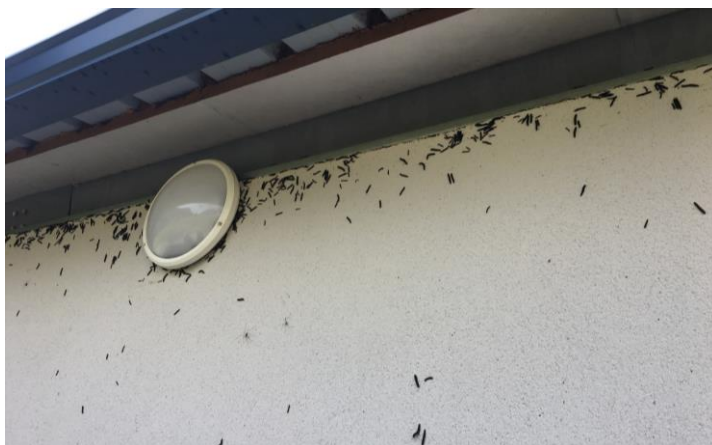
Sur un bâtiment, à GERE BELESTEN (photo CA64)
